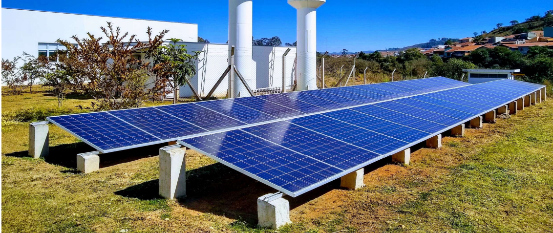
Fig. 10 - Sistema Fotovoltaico no solo.
